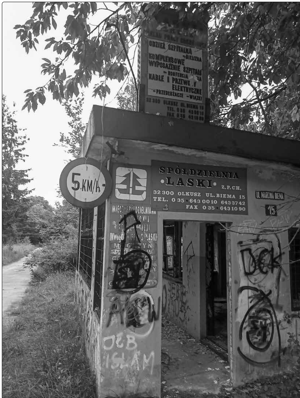
Il. 5. Zakładowa portiernia Spółdzielni Inwalidów „Laski” w Olkuszu (stan obecny). Fot. D.K.
