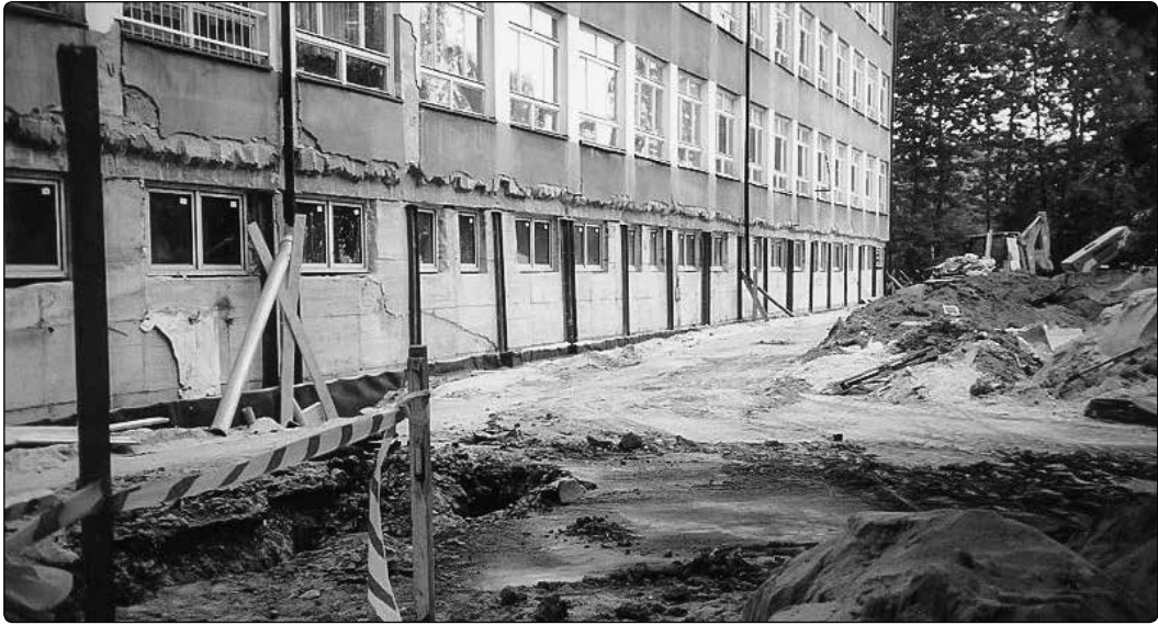
Il. 24. Remont szkoły w 2006 r. Uzupełnianie i izolacja fundamentów, wzmacnianie ścian pierwszej kondygnacji. Źródło: http://lo1.olkusz.pl/images/historia_szkoły/26.jpg
